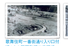
歌舞伎町一番通り入り口付近近からの区画整理工事現場
